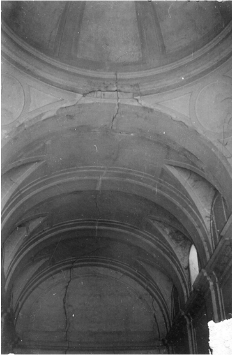
Convento de la Purísima Concepción. Estado previo de las bóvedas
