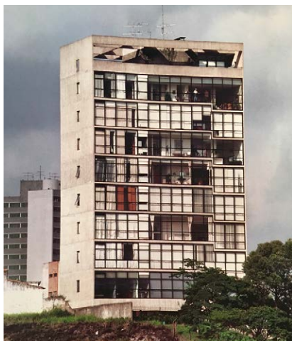
Fig.5.3.33 Edifício Jaraguá. São Paulo. 1984-88
