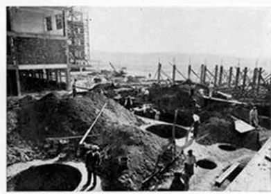
11. Iniciación de las cimentaciones en la estructura de la gran cúpula en 7 noviembre 1932.
