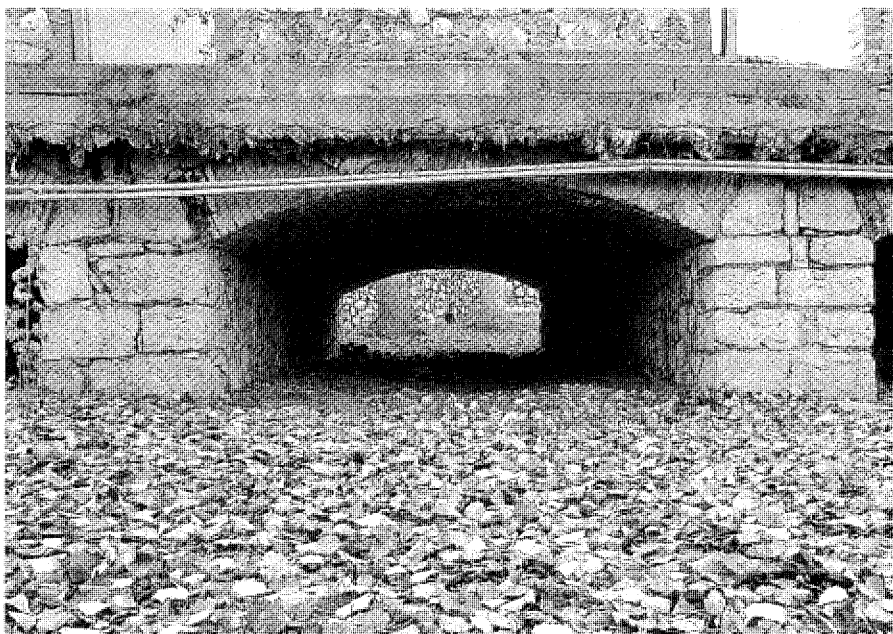
Puente del arroyo de la Vega, detalle de vano. Foto Vicente Patón.
