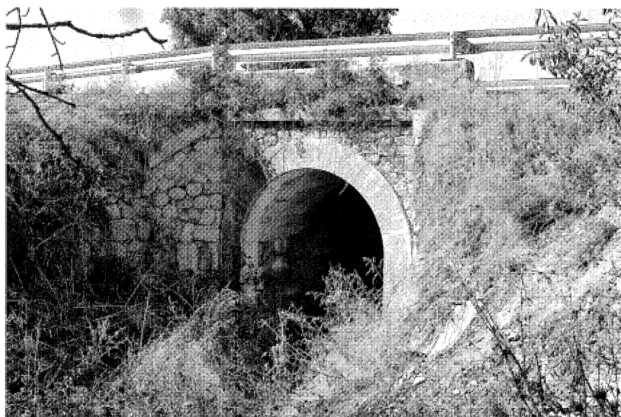
Puente del arroyo de la Cueva, alzado meridional. Foto Actividades y Servicios Fotográficos, S.A.
