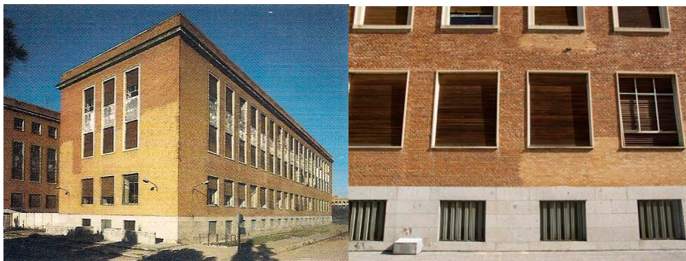
Fig.4. Imagen del Reconstrucción del ala oeste de Odontología con material de menor calidad que el original. La CUM COAM. 1988. Vol. II Fig.5. Imagen parcial de zona de ladrillo reconstruido donde se identifica el material original y el nuevo de reconstrucción (origen desconocido).
