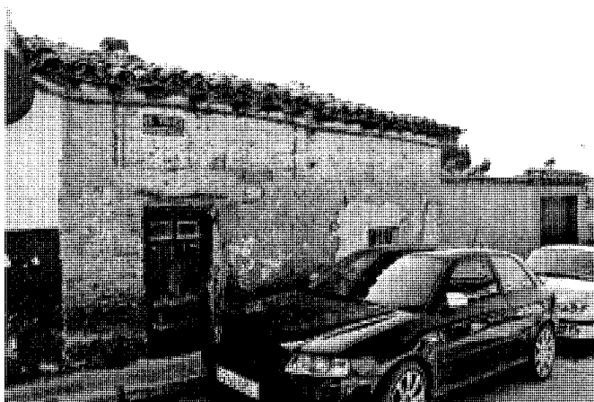
Antigua y deteriorada supervivencia rural en la calle de la Peña, 16. Foto, Jose Ablanedo, 2008.
