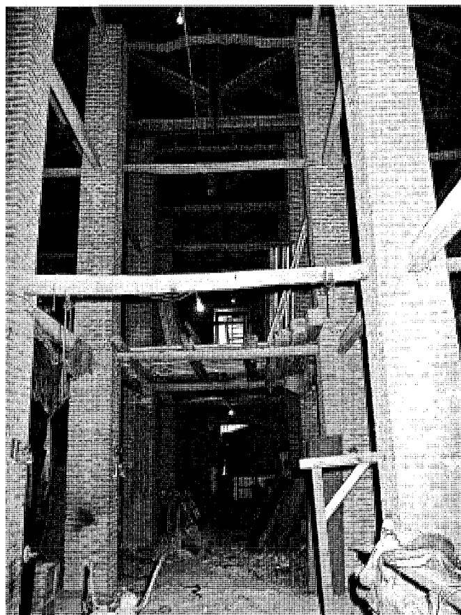
Vista general del almacén y detalle de la estructura interior. Jose Ablanedo, 2000
