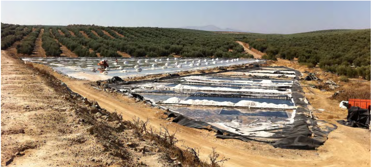
Destrucción de la configuración original de las eras de evaporación. Empleo de materiales modernos
