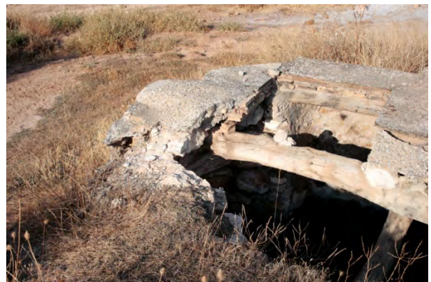
Pozo para extracción de la salmuera
