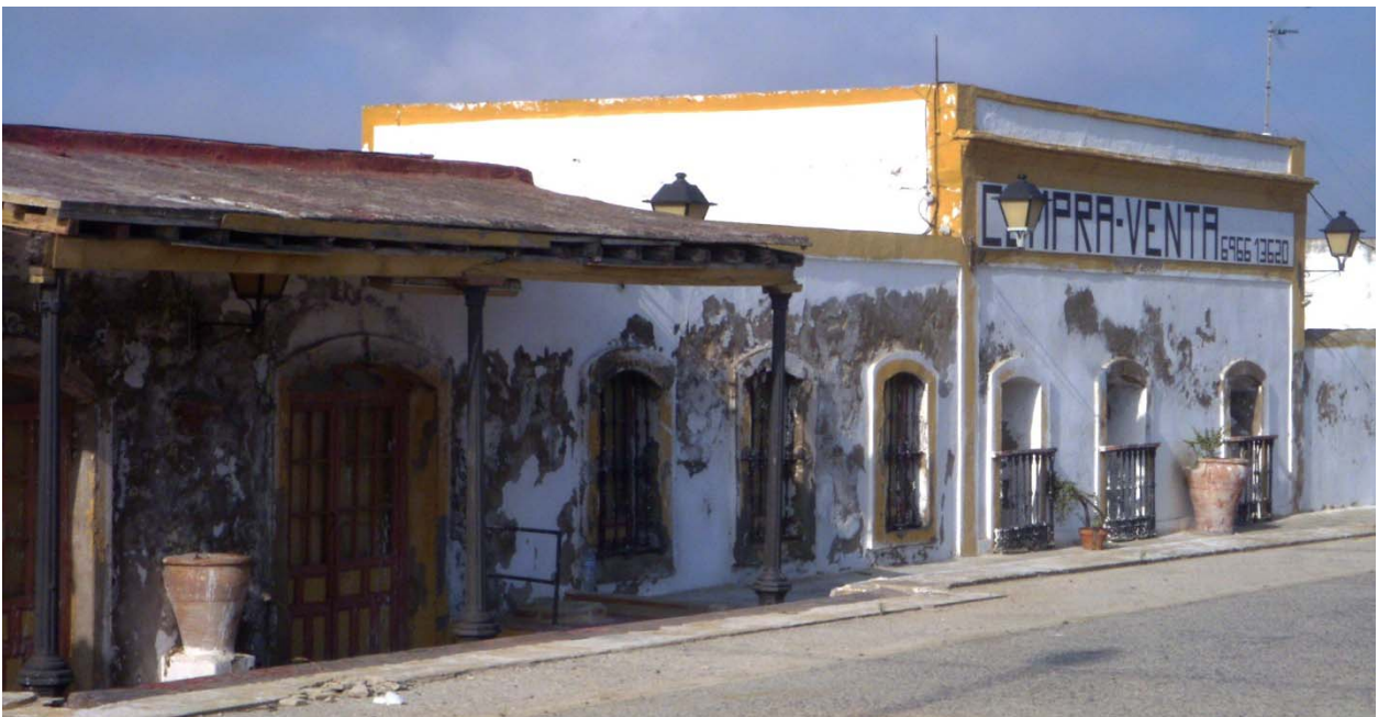
Fachada principal de la casa salinera en ruinas
