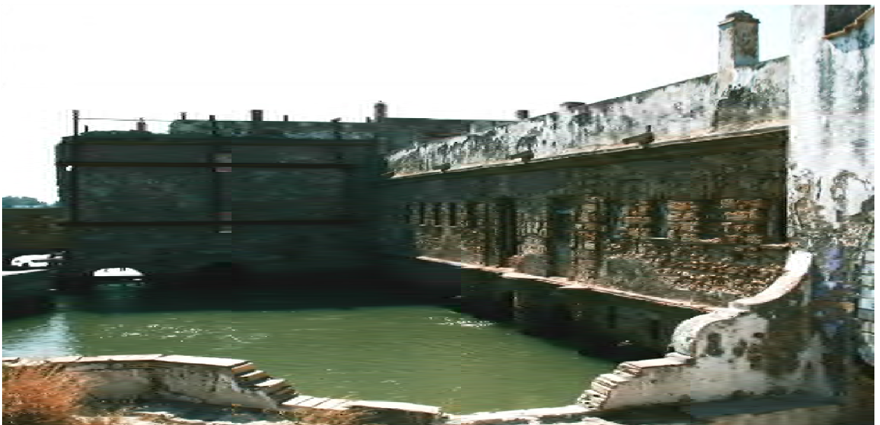
Detalle de la fachada sur del molino de marea. Estructura auxiliares refuerzan el edificio frente a derrumbes.
