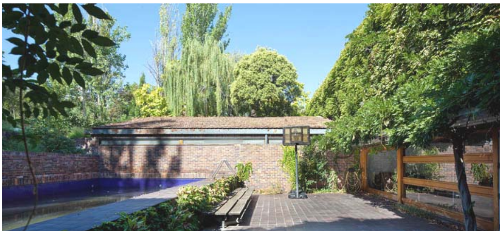
Casa Huarte. Estado actual. A pesar de los cuidados continuos de la familia Huarte la casa se está deteriorando progresivamente. Necesita una restauración integral tanto exterior interior. Entre otras actuaciones es recomendable limpiar de vegetación muros y fachadas para realizar un análisis exhaustivo de patologías. Toda la cerrajería y la carpintería requiere ser analizada minuciosamente para determinar que partes deben repararse o sustituirse. Las impermeabilizaciones, especialmente las de las cubiertas ajardinadas deberían sustituirse por sistemas actuales que garanticen una mayor protección y durabilidad. Fotografía: Miguel de Guzmán, septiembre 2011
