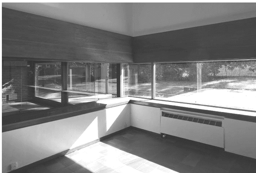
Casa Huarte. Radiadores encastrados en el cerramiento. Vista del comedor dando al patio de relación. Fotografía: Miguel de Guzmán
