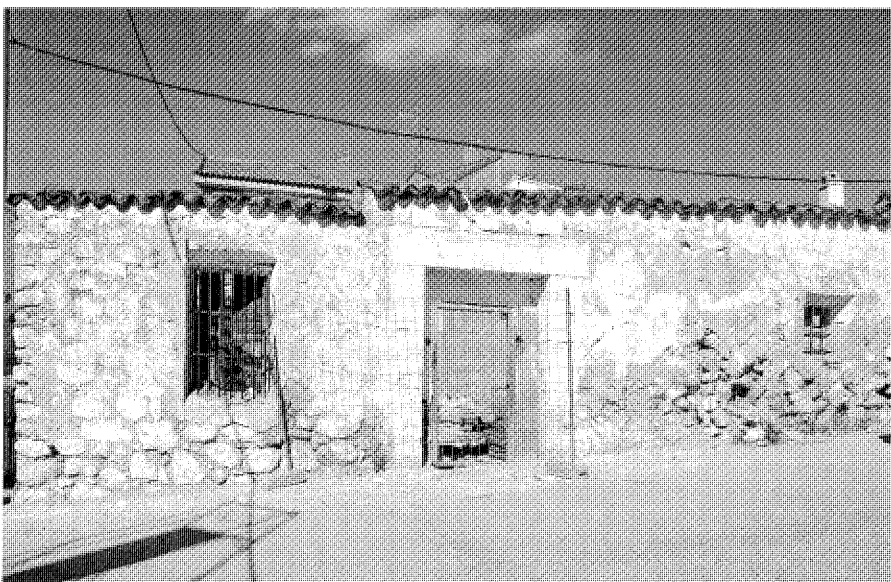
Ruinas de vivienda en la pza. de Santo Domingo 1.
