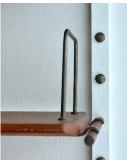
59. Imagen de detalle de alfeizar de un dormitorio, de la casa Varming, tras su rehabilitación, véase salida de aire caliente de calefacción integrada en la cámara del muro.
