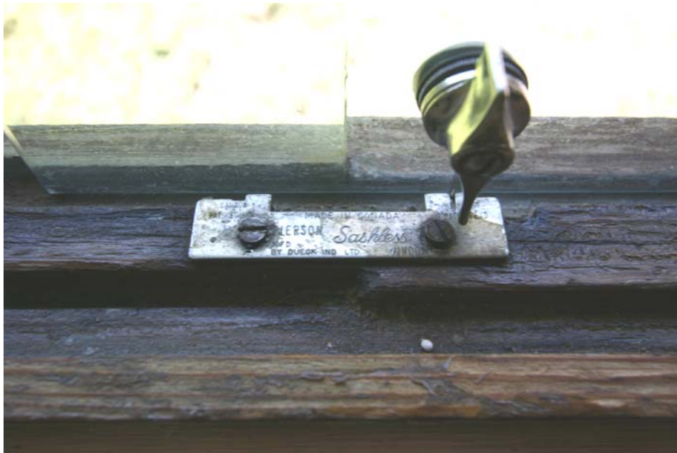
Casa Huarte. Herraje de ventana tipo Pierson atornillado al marco de madera y sistema de cierre acoplado a la hoja de vidrio
