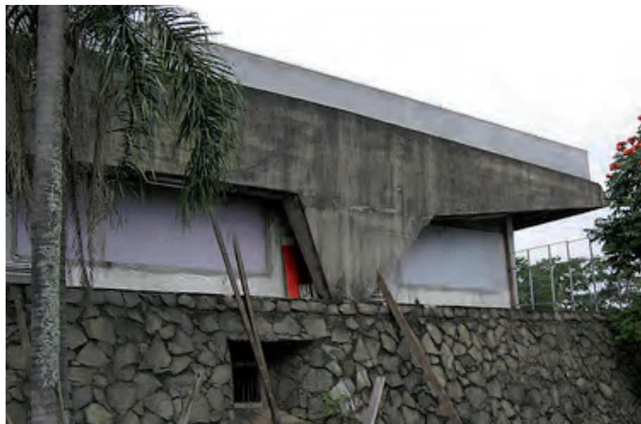
FIGURA IV.3-68 Club náutico, Sao Paulo, 1961. Arquitecto, Vilanova Artigas. El cambio de sección en la viga de esquina está expresando las solicitaciones a las que se está sometiendo. Fuente: Revista 2G, número 54, Gustavo Gili, 2010
