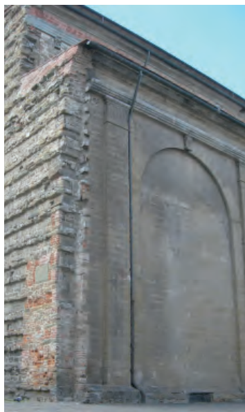
FIGURA III.2-32 Esquina de la Iglesia de San Lorenzo. El encuentro entre la fachada sin ornamentar y la fachada lateral ornamentada. Fotografía del autor.
